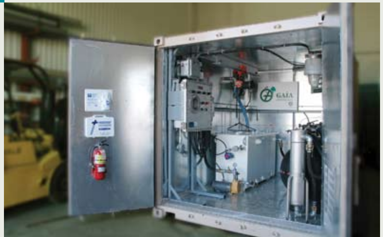
Chambre des procédés – Système d'extraction multiphase
